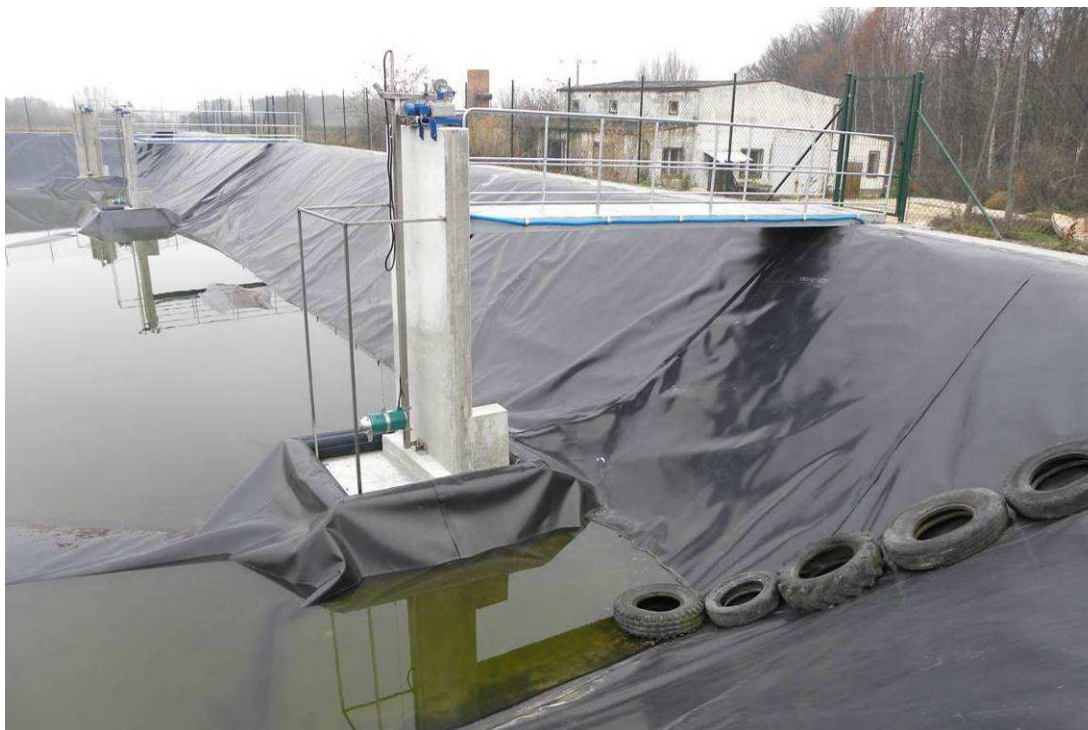
Fot. 7. Sposób zamontowania mieszadeł (zbiornik nie napelniony)
