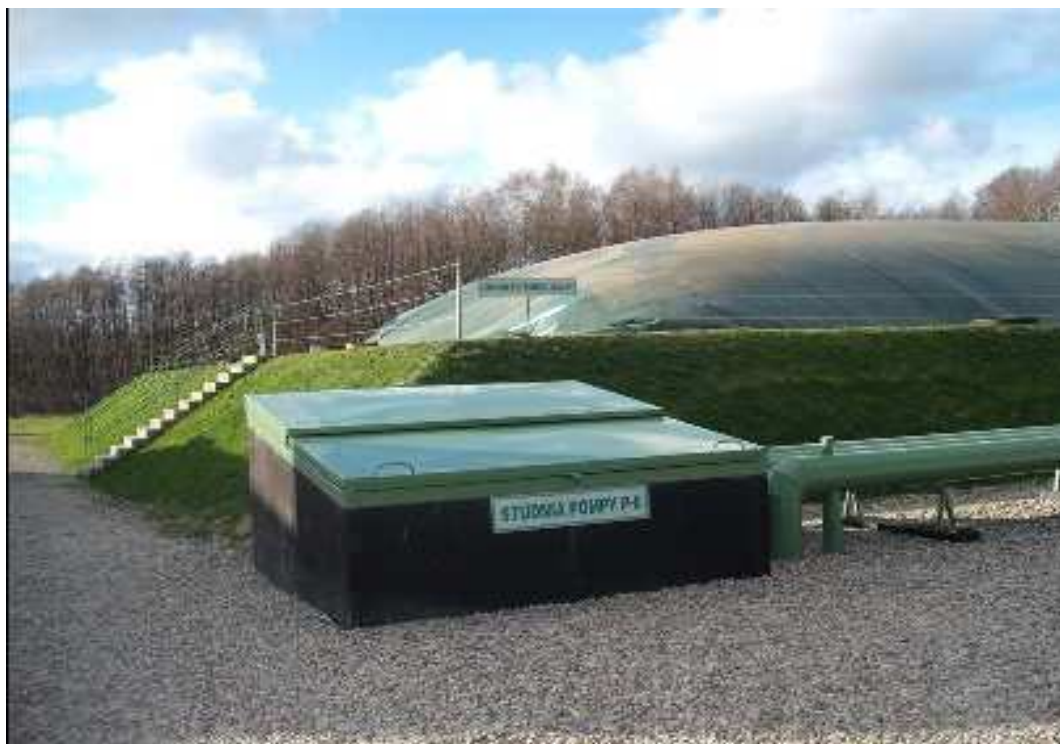
Fot. 9. Laguna ze szczelnym przykryciem wypełniona pofermentem
