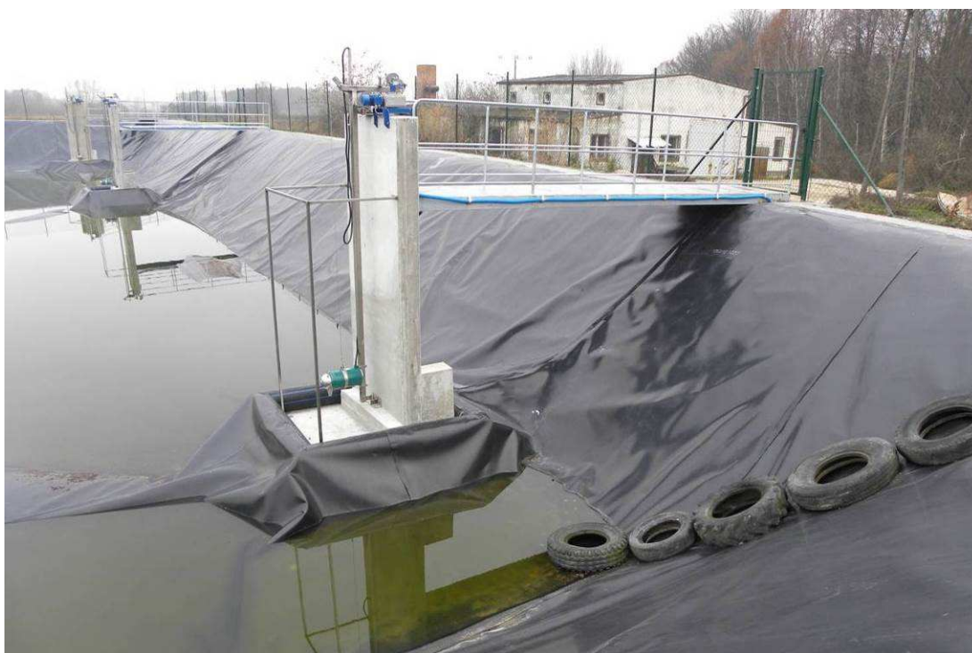
Fot. 8. Sposób zamontowania mieszadeł (zbiornik nie napelniony)
